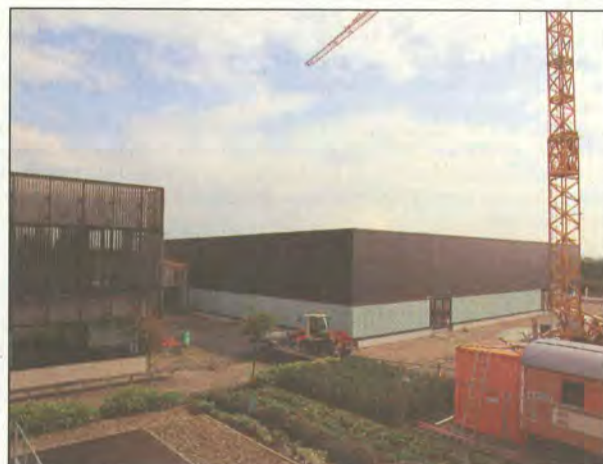
Das neue Gebäude (rechts) erhält noch eine Beschattungsfassade und wird architektonisch an das Fertigungszentrum angepasst
