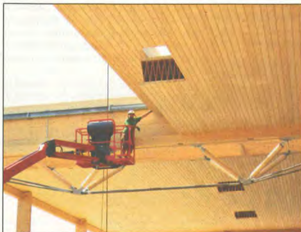
Die Dachfläche wurde in drei Wochen montiert, die Gesamtbaureisezeit der Halle betrug 15 Wochen
